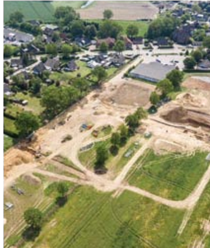
Das Projektgebiet von oben während der Tiefbauerschließung durch die Firma Eggers Tiefbau GmbH
